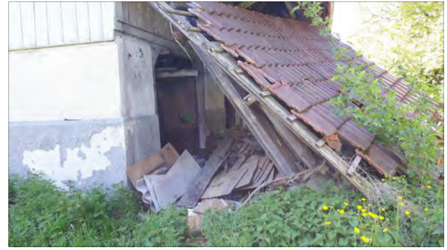
Abbildung 11: eingestürztes Vordach am nordwestlichen Wirtschaftsgebäude
